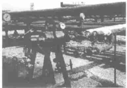
图6 引射器安装照片
