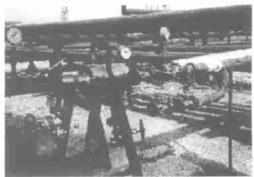
图6 引射器安装照片
