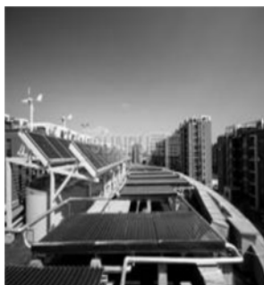
图 6 北京奥运村屋顶太阳能热水系统
