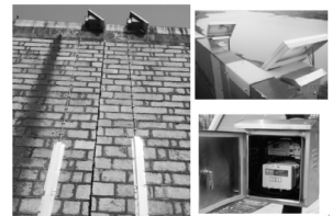
图 6 挡土墙倾测量仪现场安装实物图
