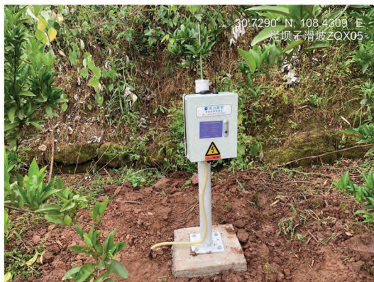
(b) 坡倾仪设备现场实物
