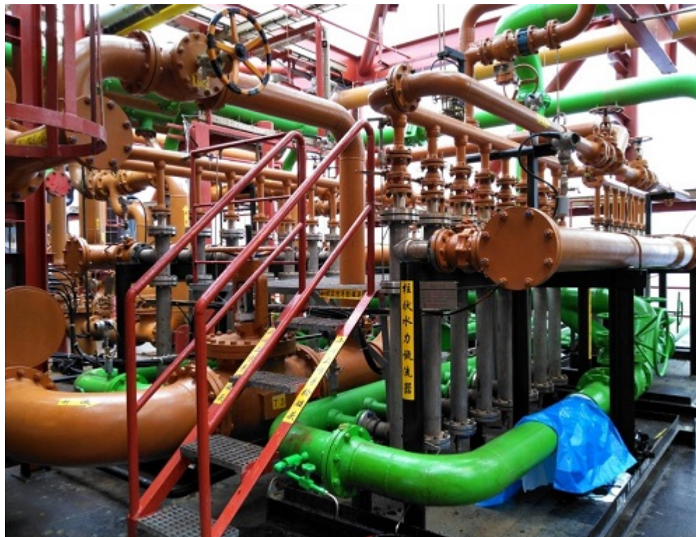
图5 FPSO管道式分离装置在南海流花油田的应用现场
