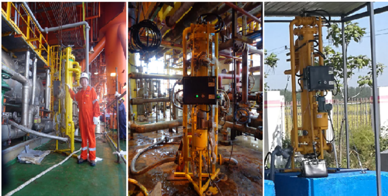
油气水三相流量计在南海恩平平台现场
