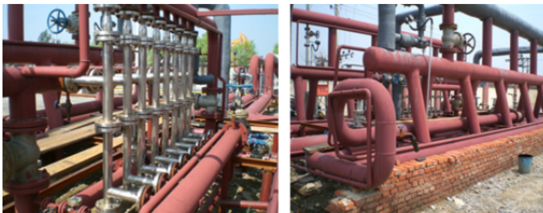
图3 超稠油管道式油气水三相分离系统在辽河油田的应用现场
