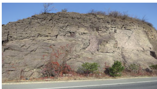
(a) 崩塌隐患点1
