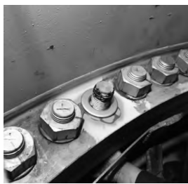
图9 检测现场发现一个存在裂纹的螺栓
