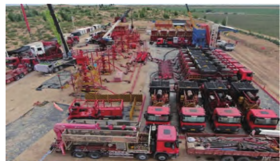
图19 酸化压裂过程中地面管汇装置
